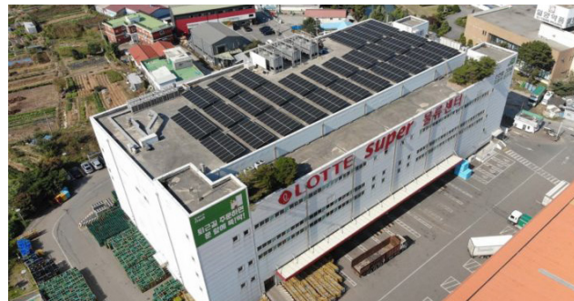
롯데슈퍼 태양광 설비
