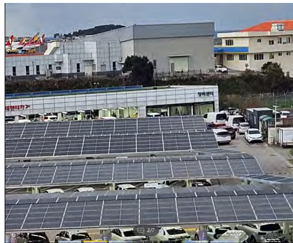
제주오토하우스 태양광 설비
