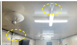
사무용 컨테이너 전기배선 (매립형 → 노출형 배선 방식) : 전기화재 확산 예방
