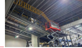
상부 점검로 구축 : 상부 장비 관리 안전
