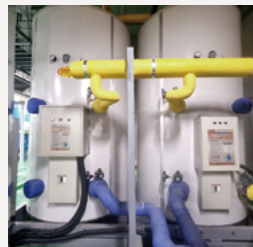
워터파크 화산동 전기 온수공급장치
