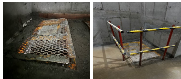
위험요소 개선 전후 모습(계단 미끄럼 방지 조치)
