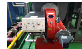
제1데이터센터 내 설치된 저 NOx 버너
