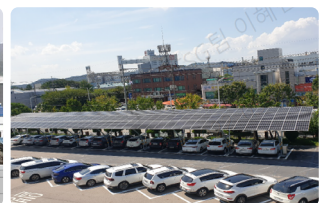
주차장 태양광 패널
