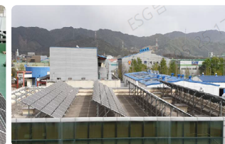
포장동 태양광 패널
