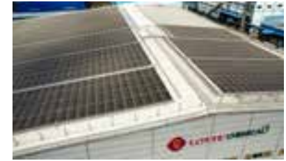
첨단 소재 베트남 태양광 발전 설비
