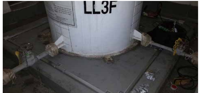
대산공장 황산 Tank 누출 감지기
