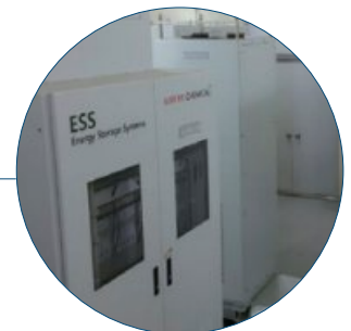
비상발전용 ESS 설치 현장
